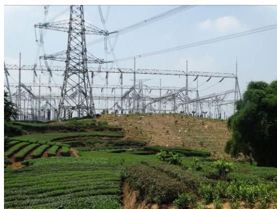
接入端南天变电站周边环境
