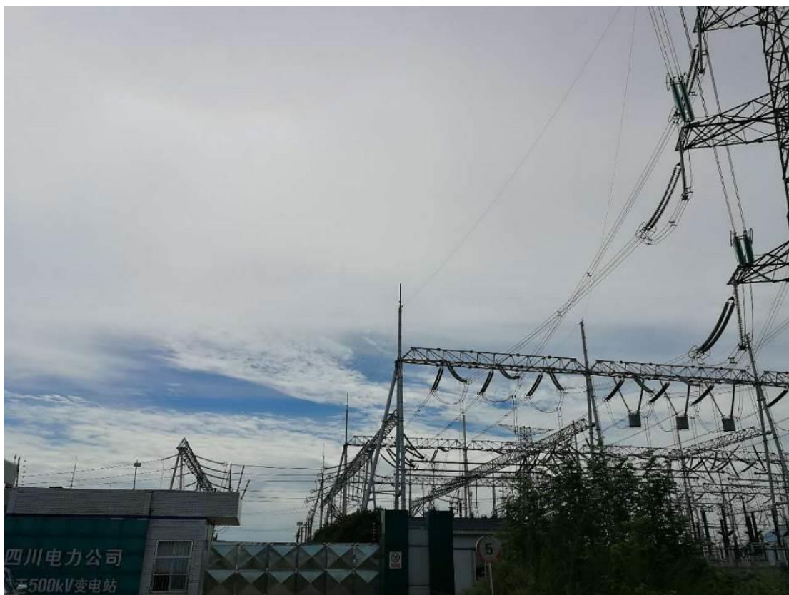
图 3-2 南天 500kV 变电站
