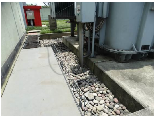
高抗下方储油坑
