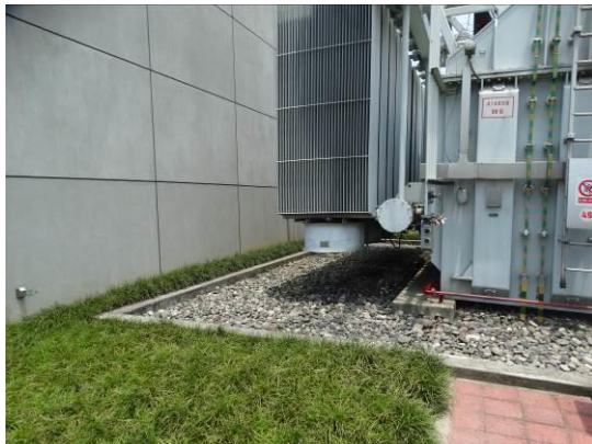
主变下方储油坑
