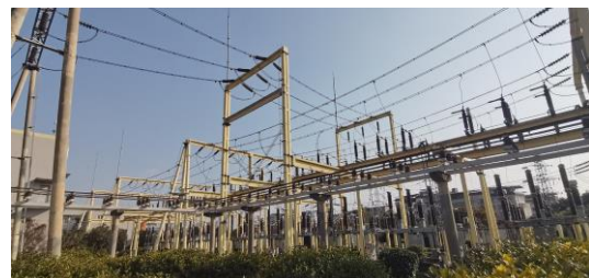
110kV 配电场地
