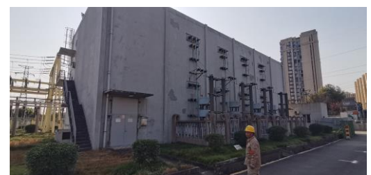
10kV 配电综合楼
