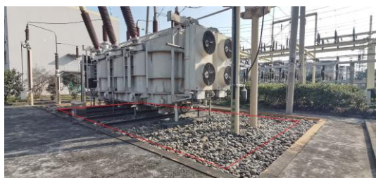
主变基础及油坑
