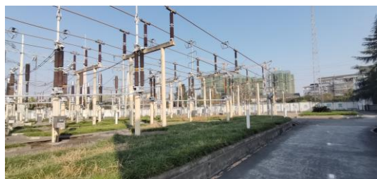
220kV 配电场地
