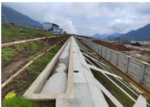
开关站截排水沟
