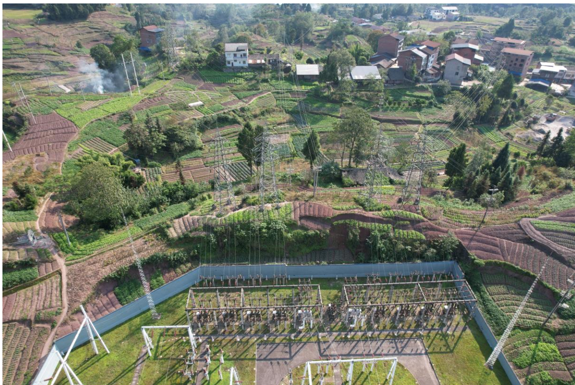
胡家 110kV 变电站 35kV 出线方向
