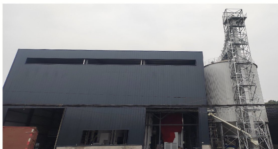
战旗村粮食仓储烘干中心已进入设备调试阶段。
