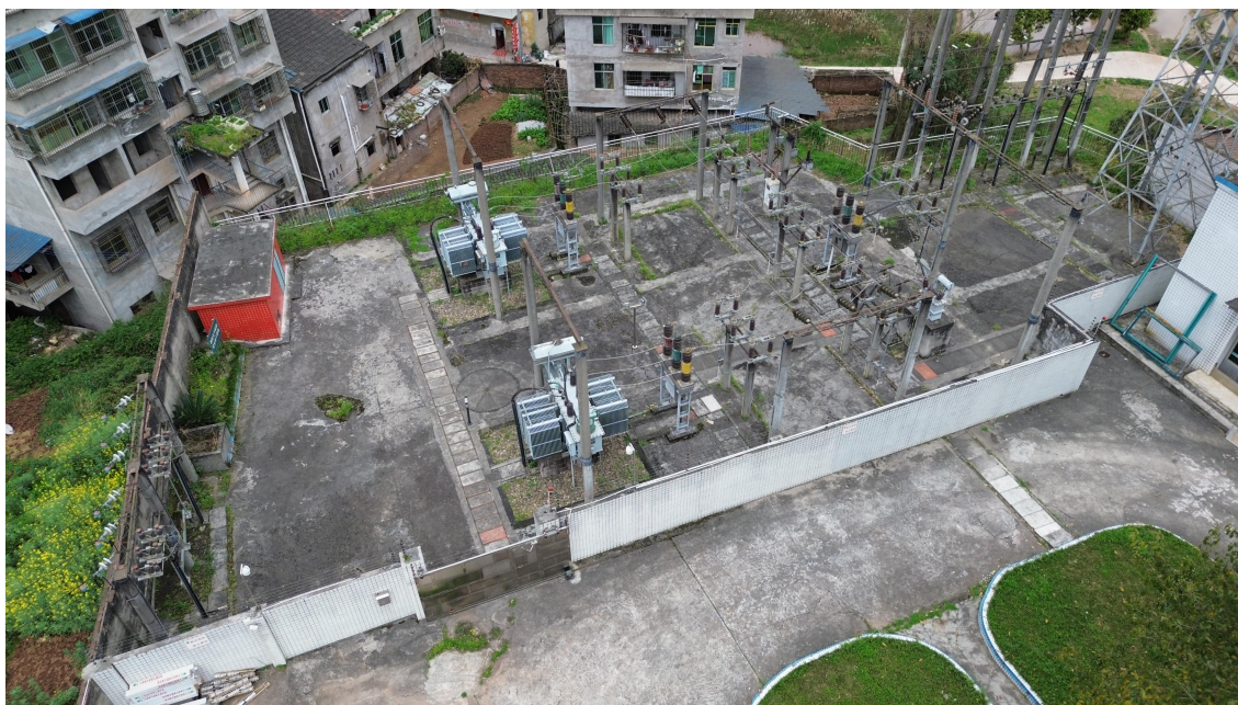
星火 35kV 变电站现状图
