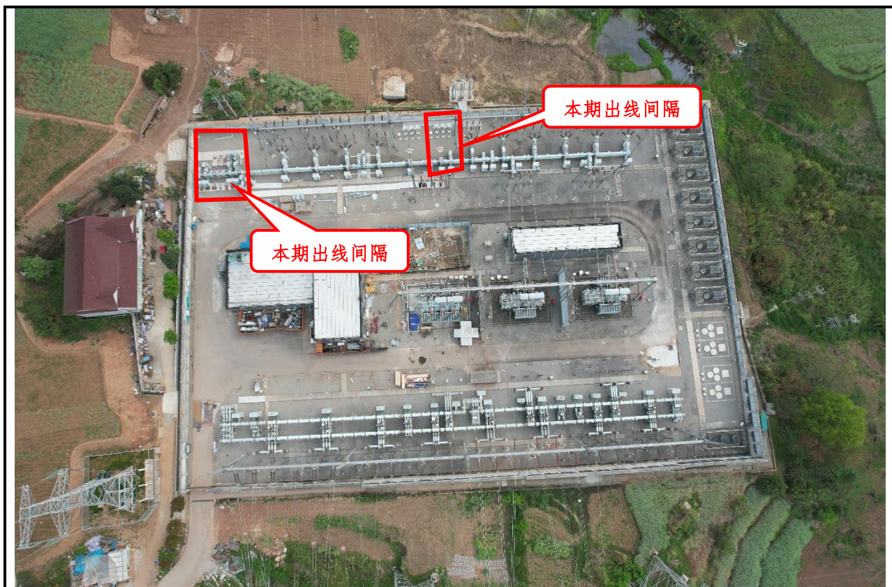
云台 220kV 变电站现状及本期出线间隔
