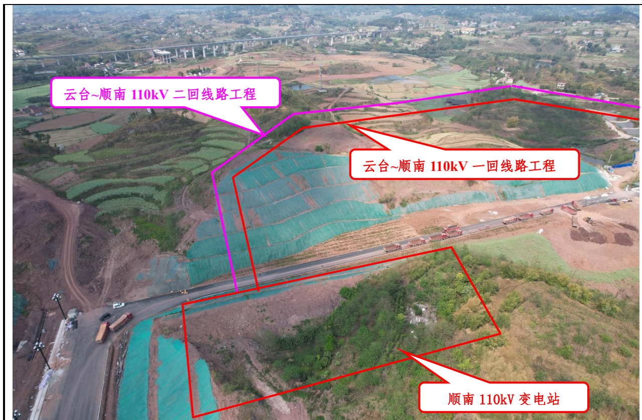
顺南 110kV 变电站出线情况
