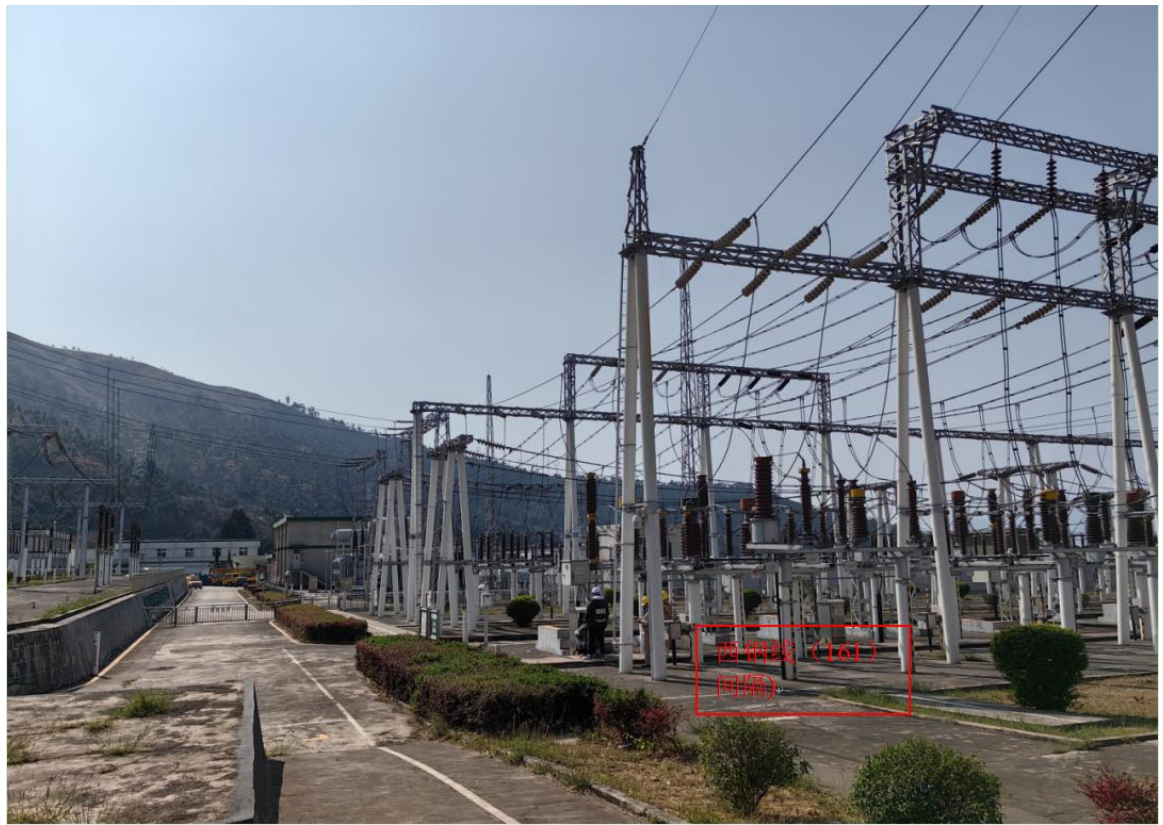
西昌 220kV 变电站—本次改造西钢线（161）间隔—现场照片
