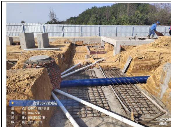
高塔站内排水管
