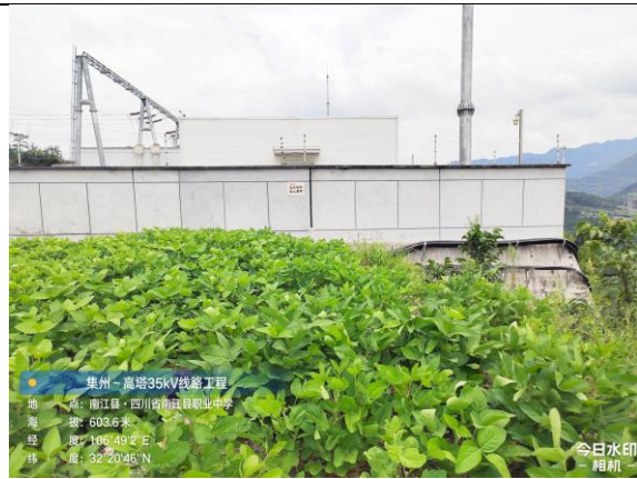
东榆 110kV 变电站侧电缆（复耕）
