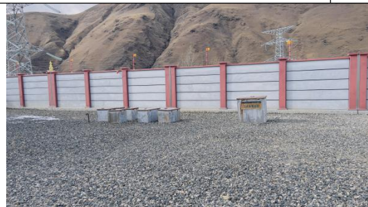
图 3-3 变电站既有地埋式污水处理装置
