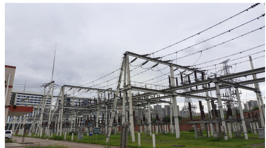
松柏 220kV 变电站-110kV 配电装置现状
