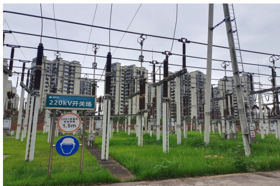
松柏 220kV 变电站-220kV 配电装置现状
