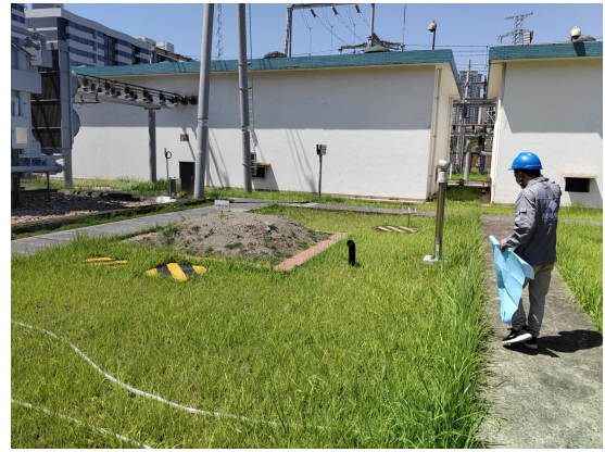
松柏 220kV 变电站-消防沙池状
