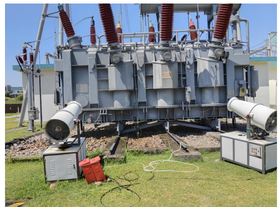
松柏 220kV 变电站-1#主变现状 220kV 配电装置现状
