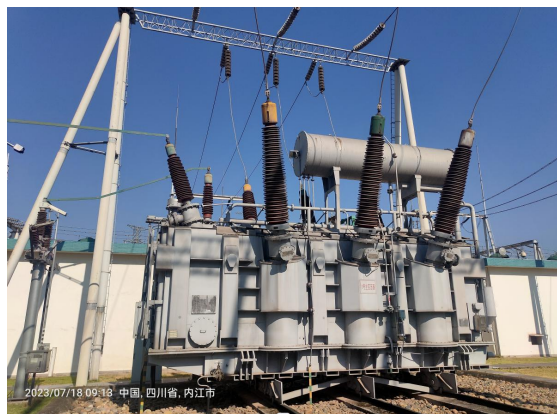
松柏 220kV 变电站-1#主变现状
