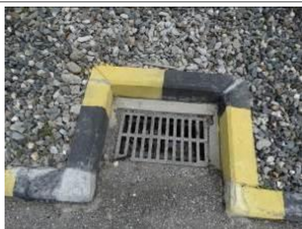
站内雨水集水井
