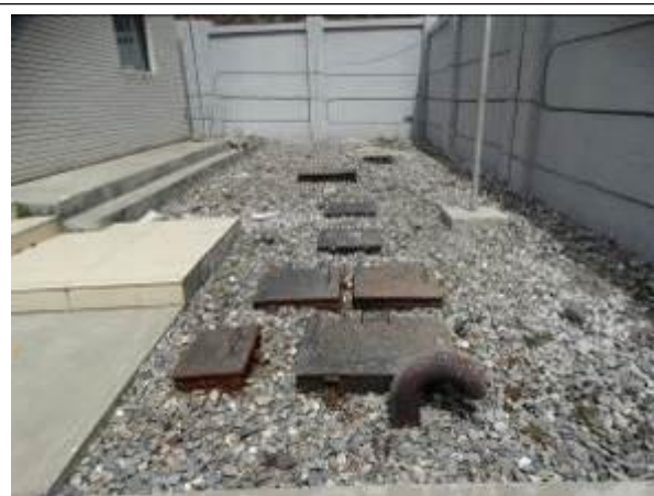
站内地埋式污水处理设施
