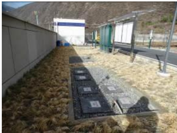
站内地埋式污水处理设施
