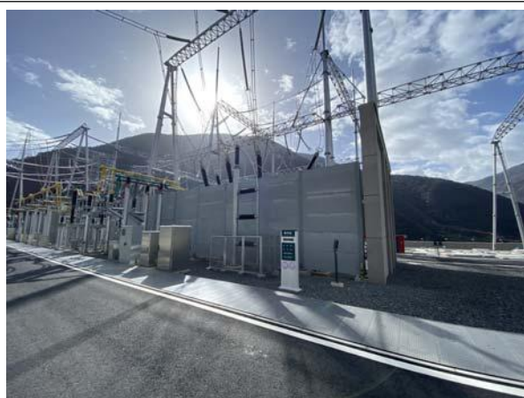
#2 主变北侧隔声屏障
