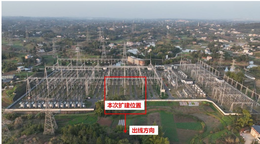
图4-3 泸州500kV变电站现状
