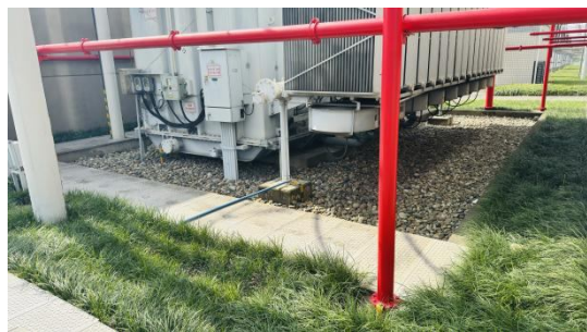
2号主变 C 相事故油坑
