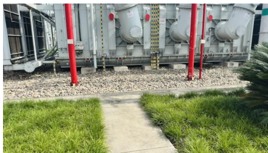
3号主变事故油坑
