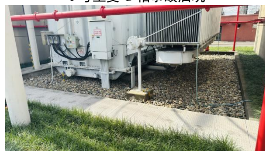
2号主变 B 相事故油坑
