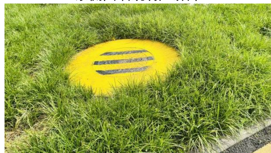
站内污水管网
