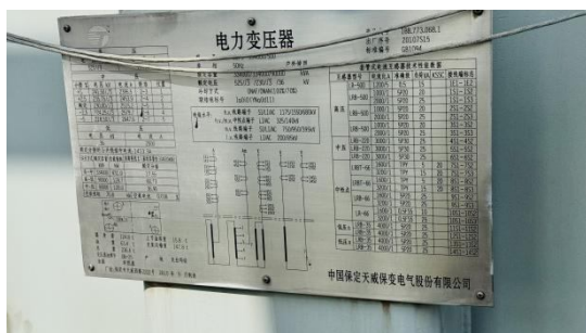
1号主变 C 相铭牌
