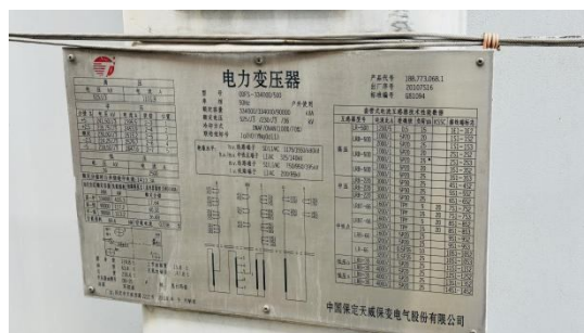
2号主变 A 相铭牌
