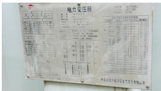
1 号主变 A 相铭牌
