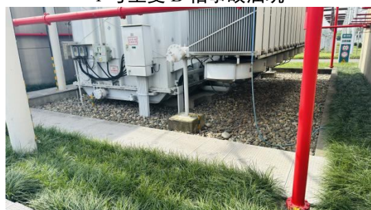
2号主变 A 相事故油坑
