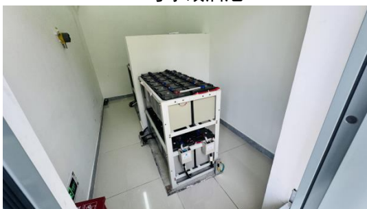
站内蓄电池室
