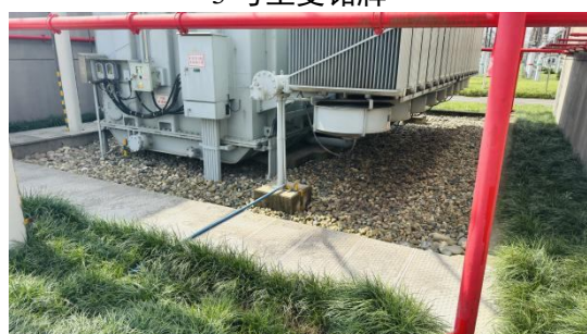
1号主变 B 相事故油坑
