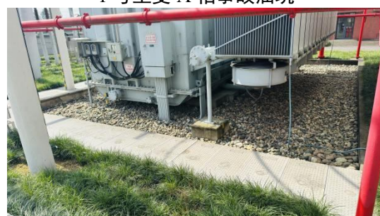
1号主变 C 相事故油坑
