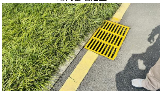
站内雨水管网
