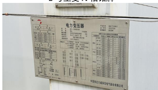
2号主变 C 相铭牌
