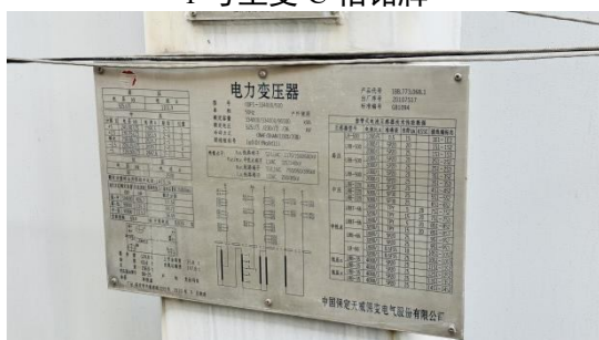
2号主变 B 相铭牌
