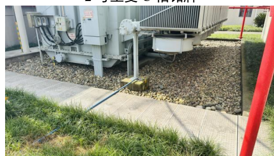
1号主变 A 相事故油坑
