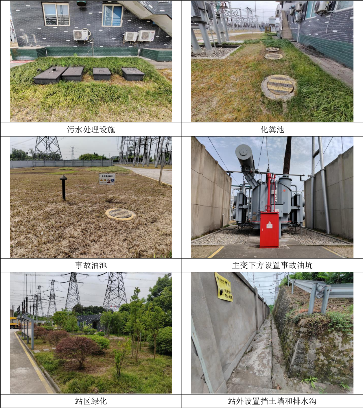
图 3.1-3 达州500kV 变电站前期工程已采取的主要环保设施、措施
