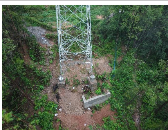
草池一岭上 N87 塔砂石余料未及时清理，坡地堆土未采取挡护措施，未进行覆土、土地整治
