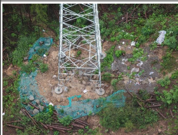
草池一岭上 N76 塔砂石料未清理，土石方堆放散乱，未及时进行覆土、土地整治
