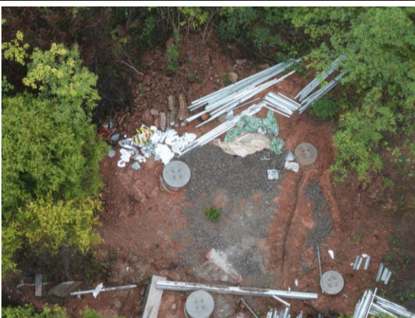
永安一岭上 N22 塔砂石料堆放散乱，未及时进行覆土、土地整治
