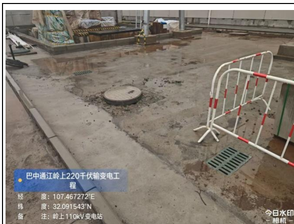
雨水口、雨水检查井
