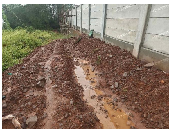
站区周边临时排水、沉沙措施不足，未及时采取临时苫盖
