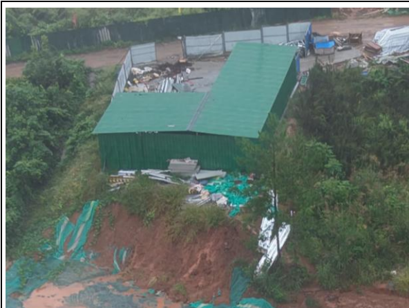
施工临时场地周边未设置临时拦挡沉沙措施，裸露坡面临时苫盖不足
