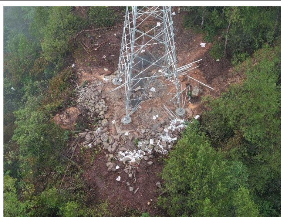
永安一岭上 N35 塔砂石余料未清理，土石方堆放散乱，未及时进行覆土、土地整治和植被恢复
