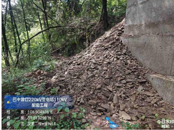
文龙二线 \pi 接线路 N14 塔塔位下侧挡墙实施范围不足
