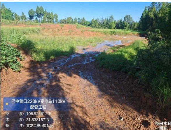
文龙二线 \pi 接线路 N4 塔新修汽运道路地表侵蚀沟明显，未采取临时苫盖措施
