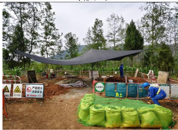
文龙二线 \pi 接线路 N19 塔表土剥离、临时遮盖、临时铺垫
