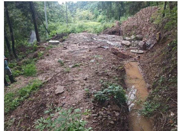
杨南改接线路 N41 塔塔基及塔基施工场地未开展表土剥离及堆存保护，土石方堆放散乱，未采取苫盖措施，临时排水不完善
