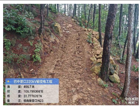
杨南改接线路 N23 塔新修汽运道路未采取临时苫盖、排水、沉沙措施
