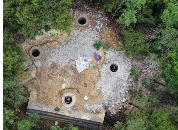
文龙二线 \pi 接线路 N21 塔塔基及塔基施工场地未开展表土剥离及堆存保护，土石方堆放散乱，未采取苫盖、铺垫措施
