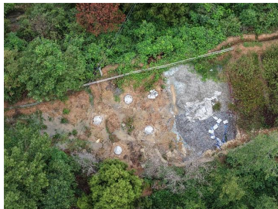
通杨 \pi 接线路 N6 塔塔基及塔基施工场地地表积水严重，未采取临时排水、苫盖措施
