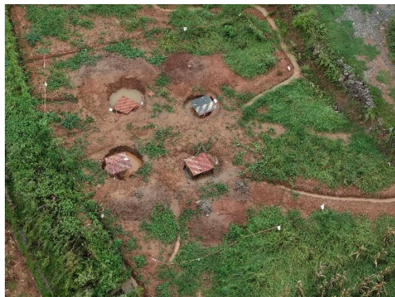
通杨 \pi 接线路 N5 塔塔基及塔基施工场地未开展表土剥离及堆存保护，未采取苫盖措施
