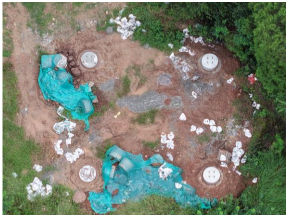
杨南改接线路 N32 塔塔基及塔基施工场地表土剥离及保护不到位，砂石料堆放散乱且未铺垫，苫盖措施不足
