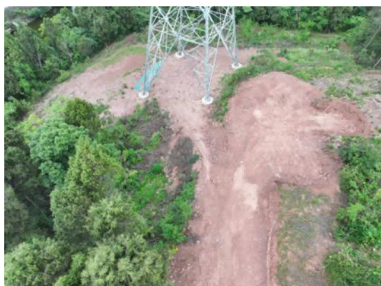
图5-3 NA5塔基旁施工平台平整不到位
