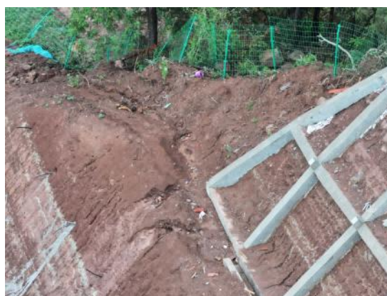
图5-5 变电站边坡排水沟目前未顺接到位
