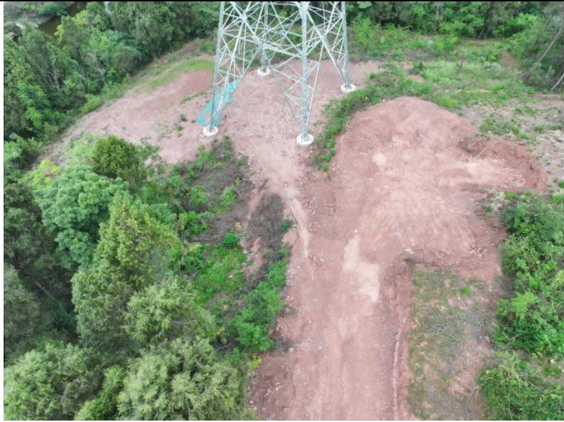
NA5 塔基旁施工平台平整不到位
