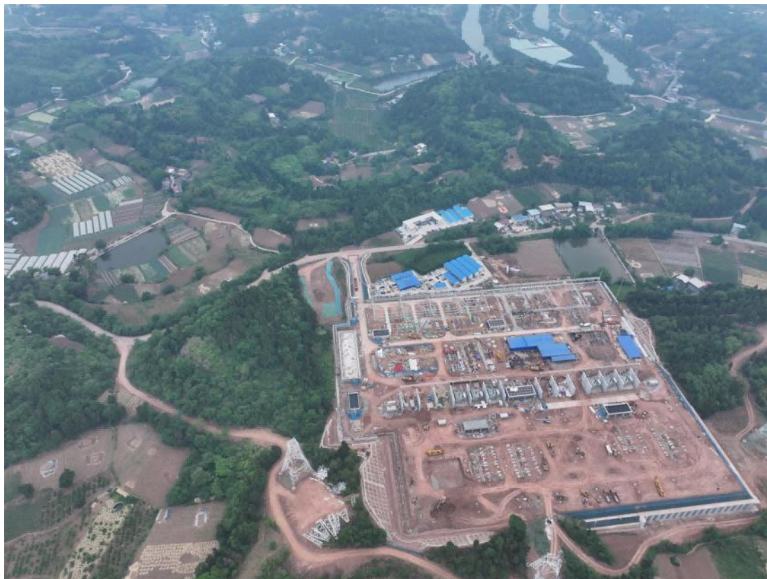
图8-1 变电站俯瞰图
