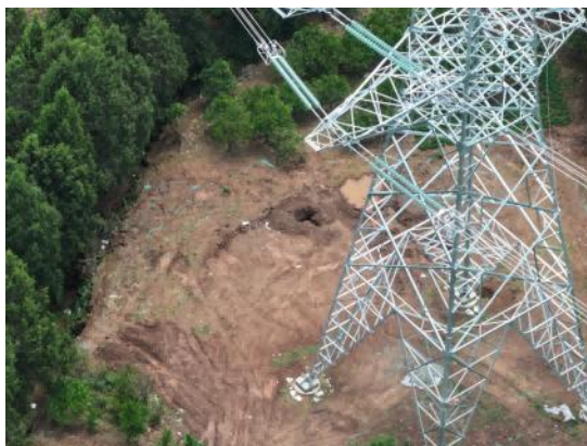
图5-2 NC46塔基平整不到位
