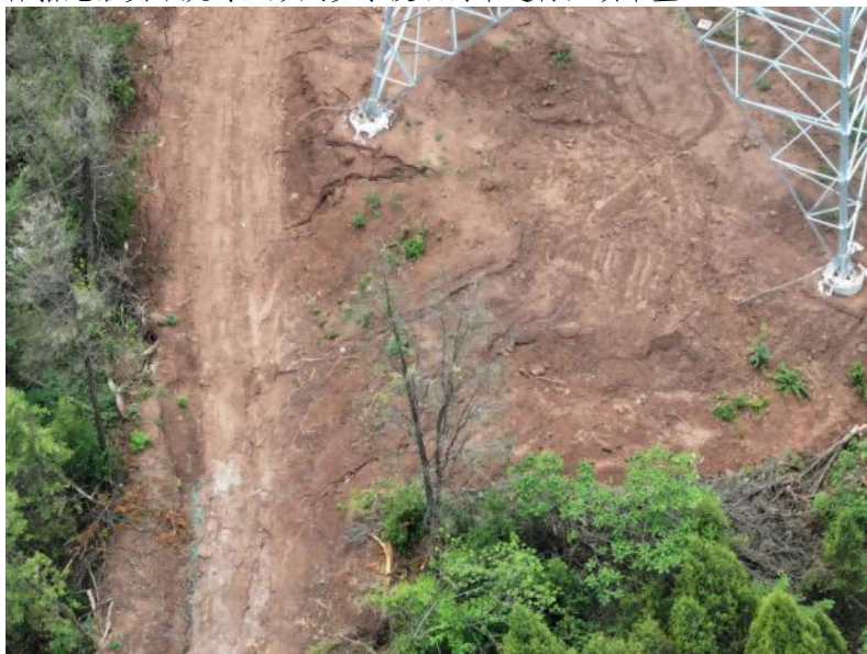
NC20 塔基基面存在侵蚀沟
