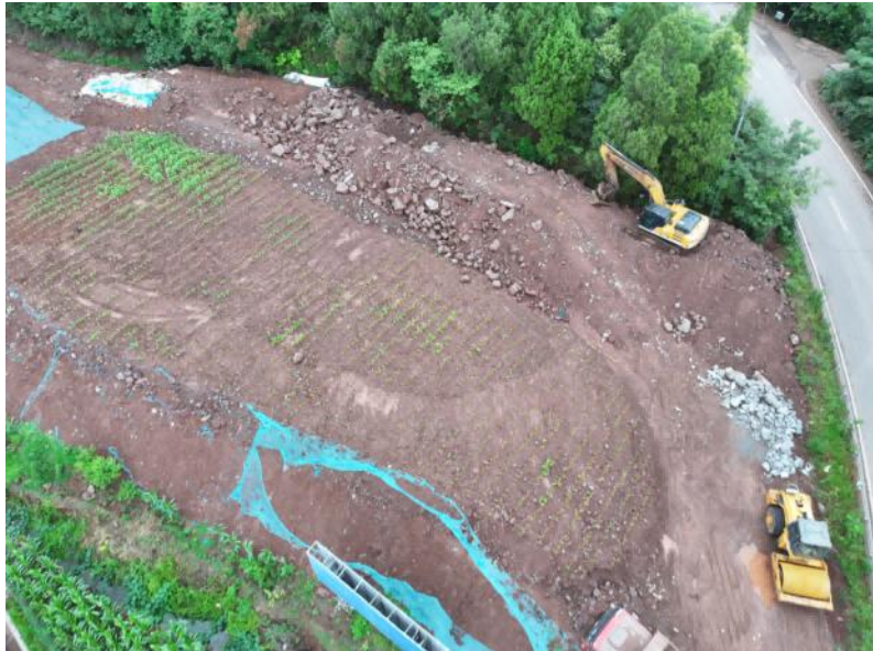
变电站旁余土临时堆土场平整不到位
