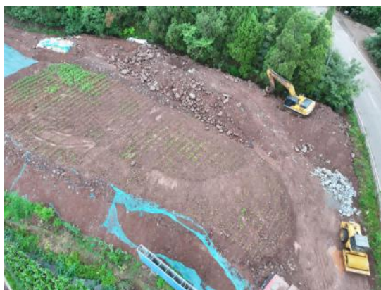
图5-4变电站旁临时堆土场平整不到位
