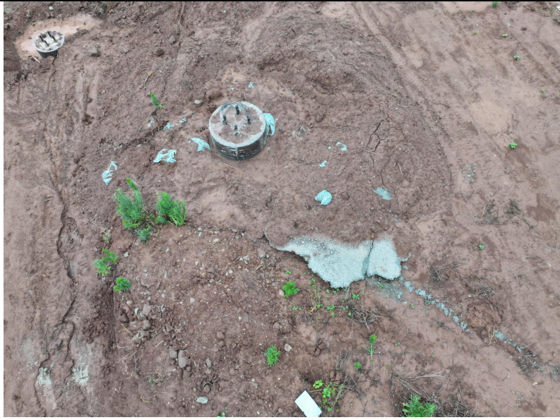
N11 塔基施工便道随意倾倒水泥浆
