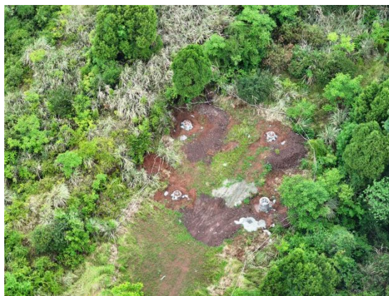
图5-2 N9塔基开挖堆土未进行苫盖
