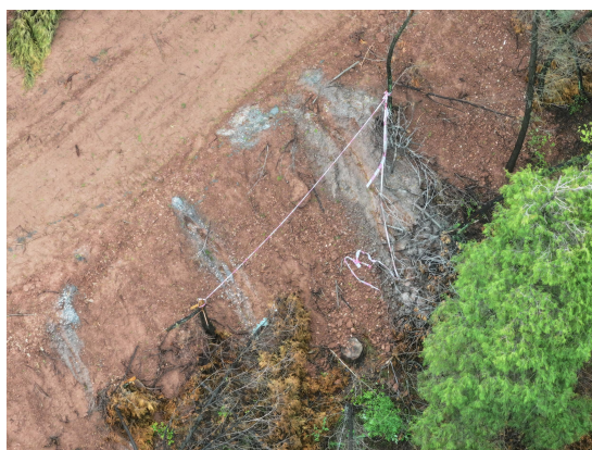
图5-6 N26塔基随意倾倒水泥浆
