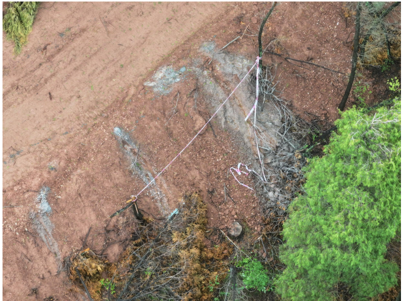
N26 塔基施工便道随意倾倒水泥浆
