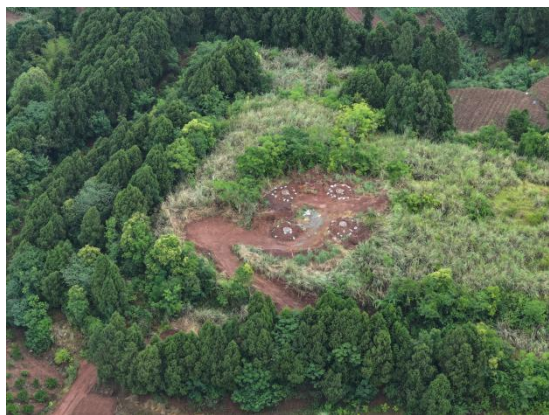
图5-1 N8塔基水泥浆清理不到位
