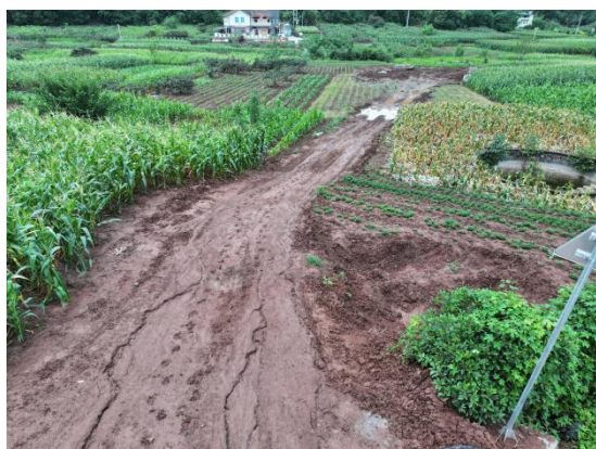
图5-5 N23塔基基面冲刷严重
