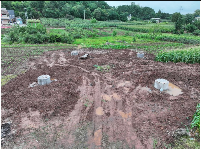
N23 塔基开挖堆土未苫盖、拦挡、平整
