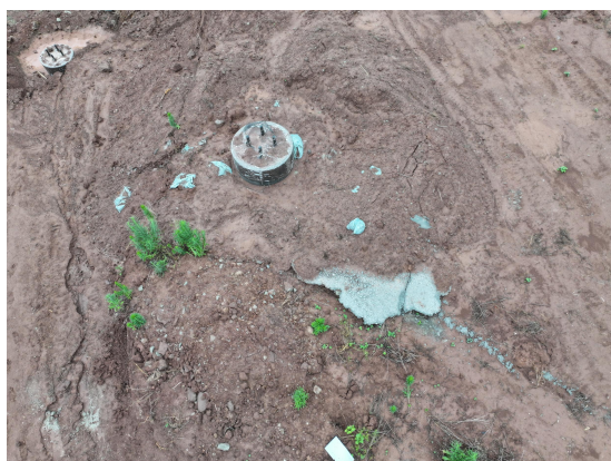
图5-3 N11塔基缺少临时排水沟
