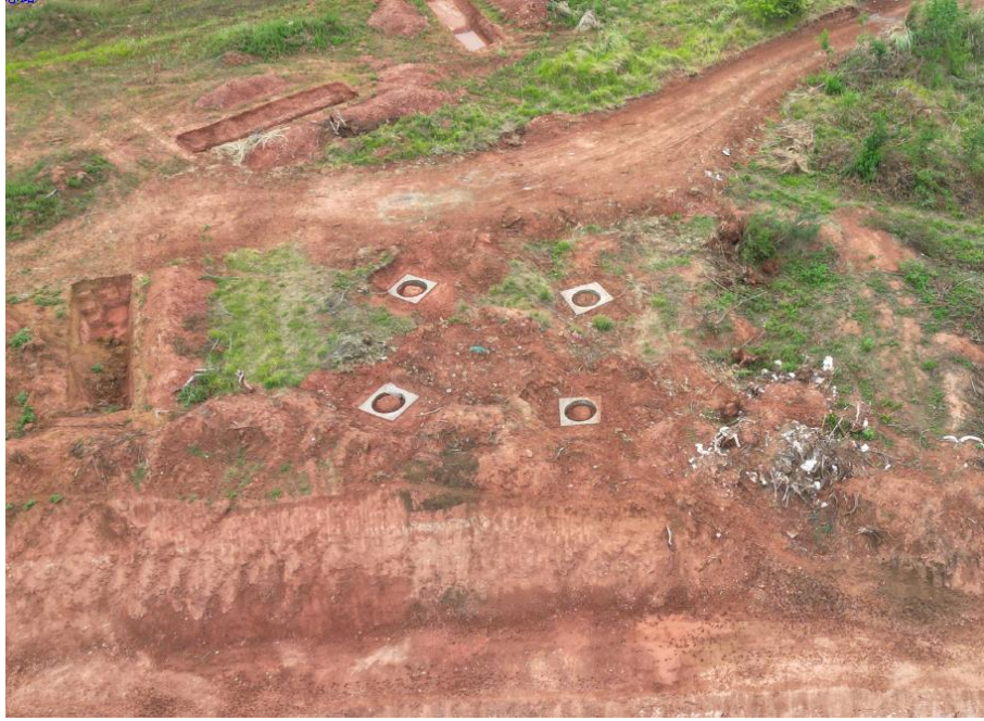
NA59 塔基边坡未拦挡、覆盖
