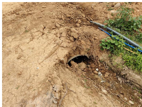
图5-2 NA2塔基排水沟堵塞未疏通
