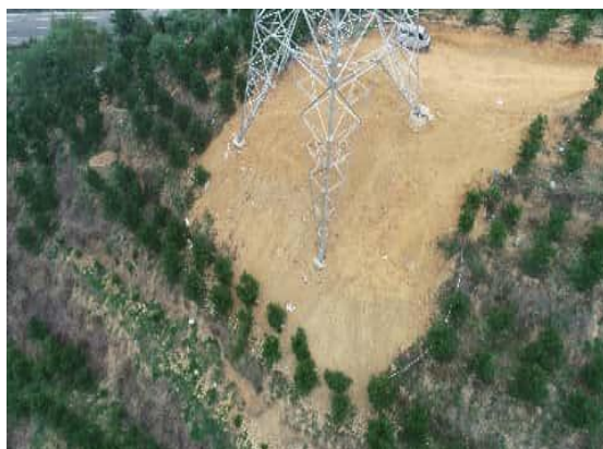
图5-3 NB17塔基边坡缺少拦挡
