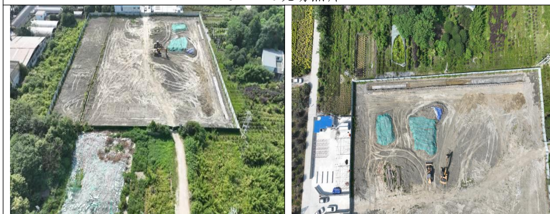
变电站现场照片
