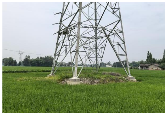
苏场—福田 N35 塔位现状（基面已长草）
