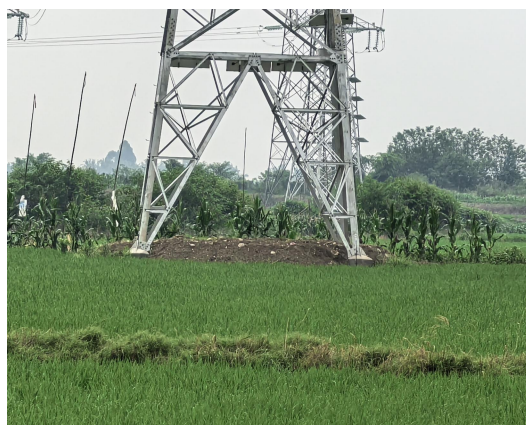
苏场—邛崃 N19 塔位基面裸露，需尽快实施撒草绿化措施
