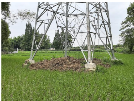
庄园—解林 N29 塔位基面裸露，需尽快整平后补充撒草绿化措施
