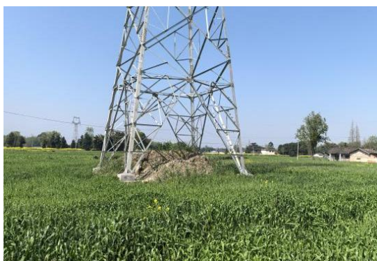
苏场—福田 N35 塔位基面余土未摊平
