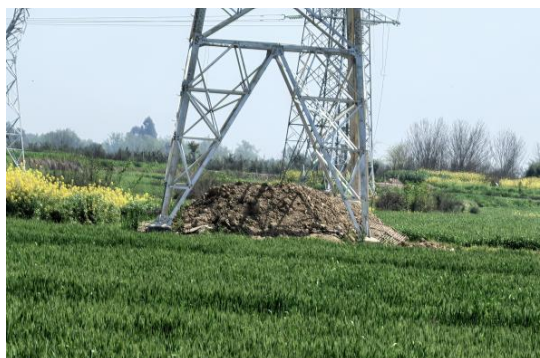
苏场—邛崃 N19 塔位基面余土未摊平
