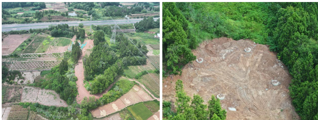
图5-5 N67塔基及施工道路存在侵蚀沟 图5-6 N70塔基开挖堆土缺少苫盖、拦挡
