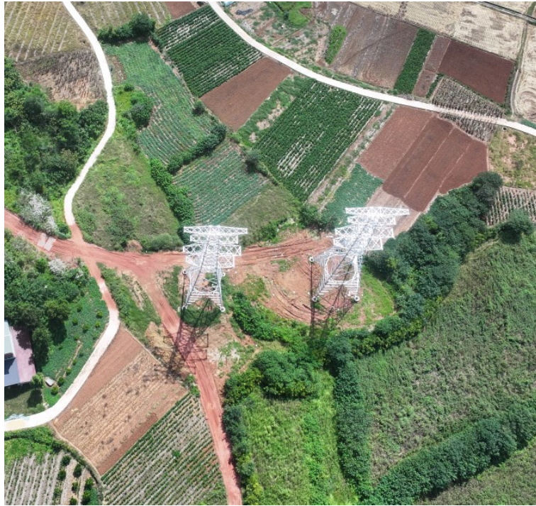
NB/NA04缺少临时排水沟且道路存在侵蚀沟、裸露地表未苫盖
