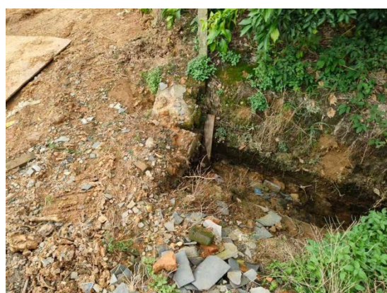
图5-4 ND10塔基排水沟出口堵塞
