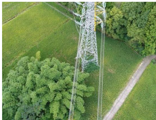
庄园—解林 N29 塔位现状（基面已长草）
