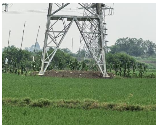
苏场—邛崃 N19 塔位基面裸露
