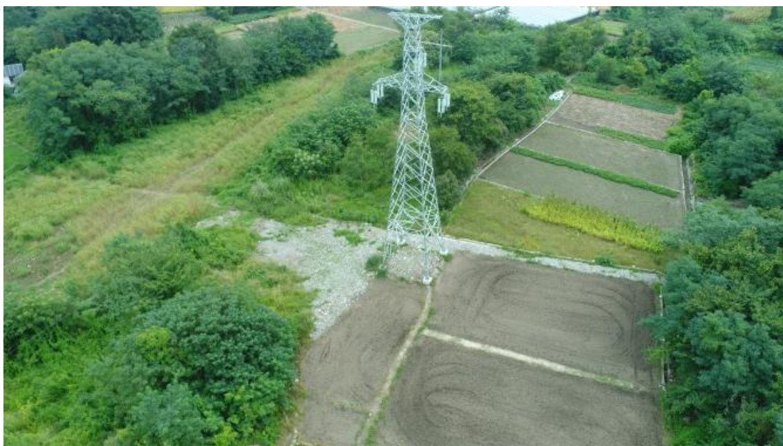
N17 塔基永久占地和施工临时场地区域植被恢复差
