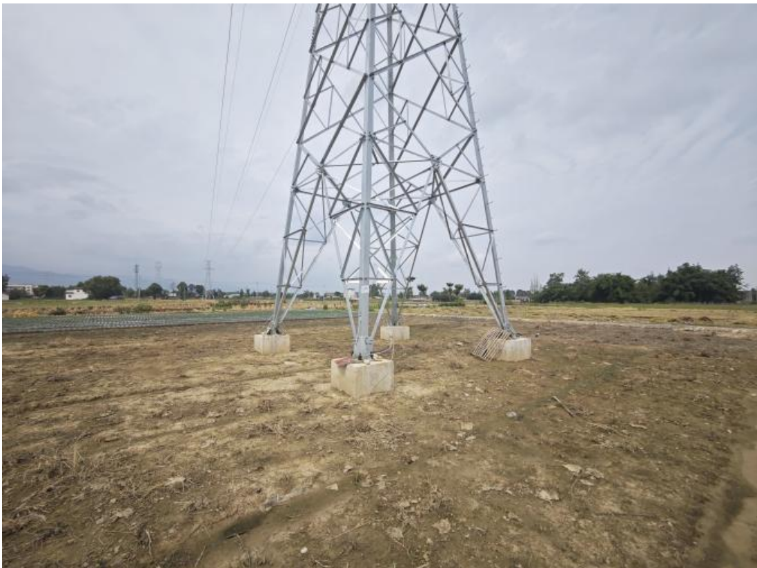
N49 塔基永久占地区域无植被恢复
