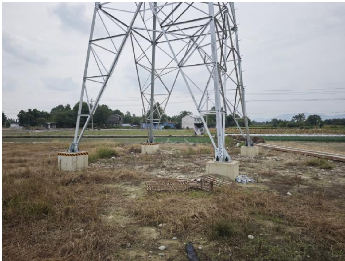
N45 塔基永久占地区域植被恢复差且施工场地存在建渣垃圾
