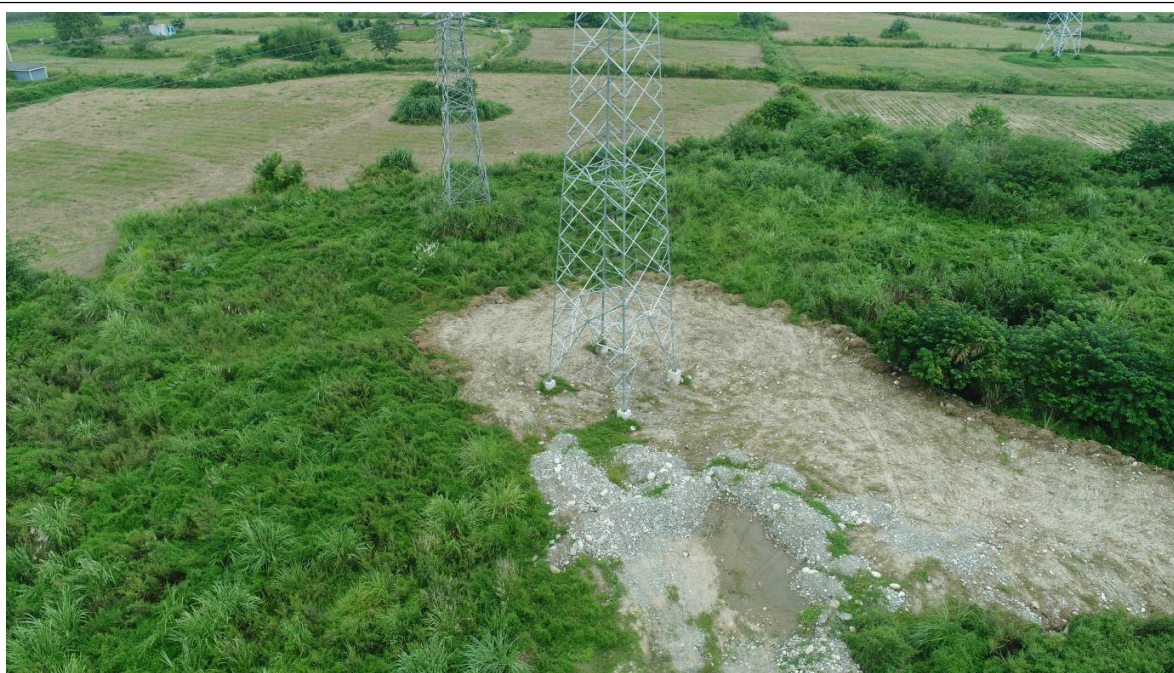
N20 塔基施工区域存在堆弃的土石方、土地整治、恢复植被
