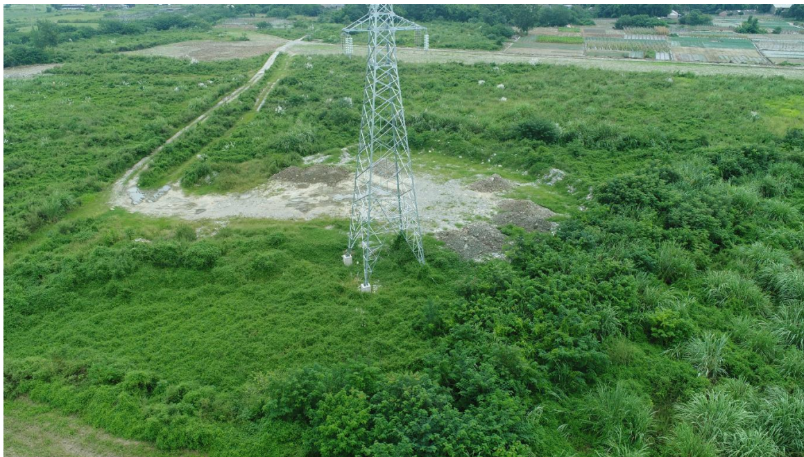
N19 塔基施工区域存在堆弃的土石方未摊平、土地整治、恢复植被
