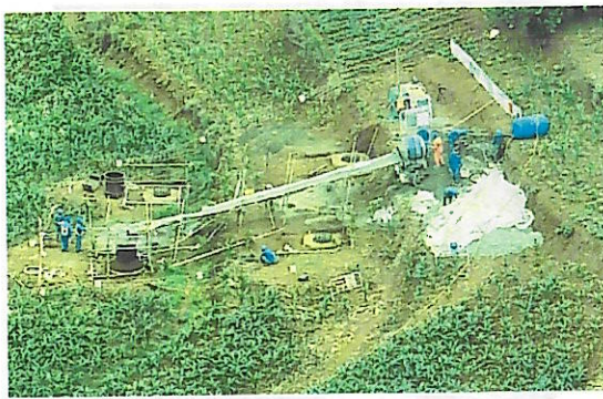
NB126 塔位上方堆料区防雨布铺垫、遮盖
