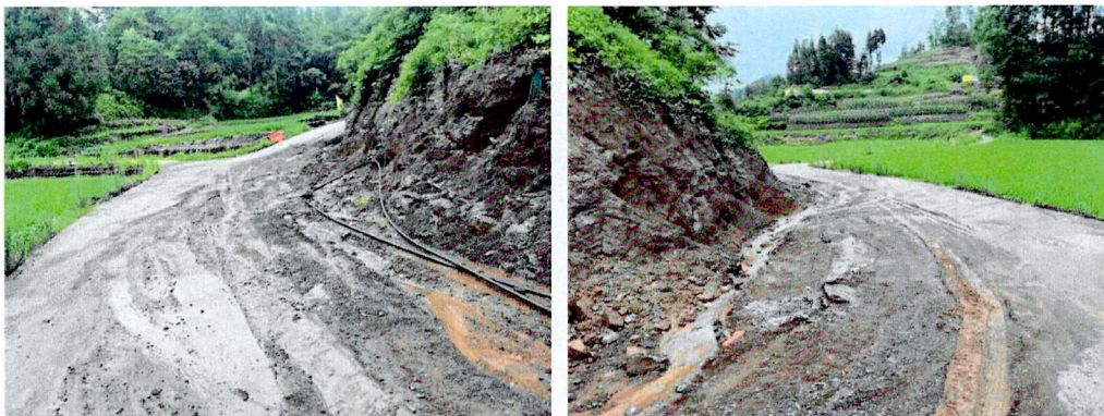
扩建进站道路排水沟未修建
