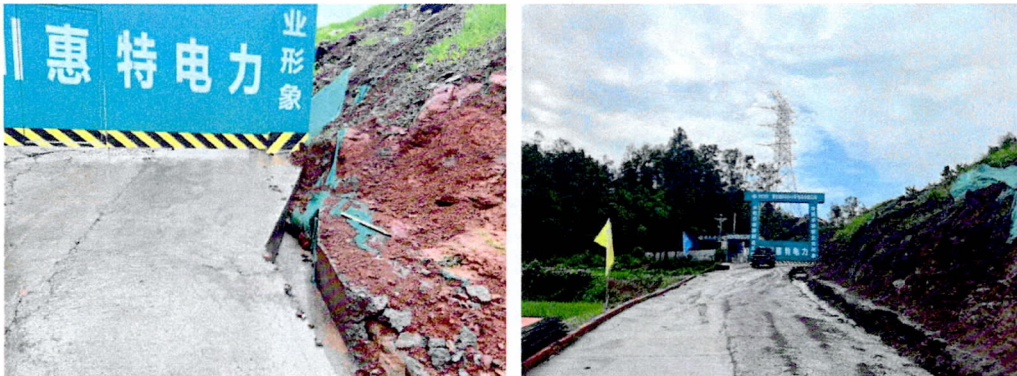
排水沟淤积、临时遮盖损坏
