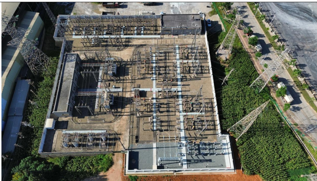
经久 110kV 变电站
