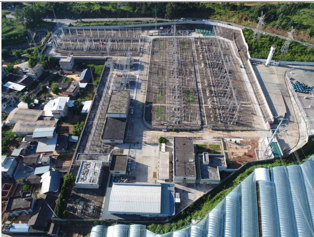
西昌 220kV 变电站
