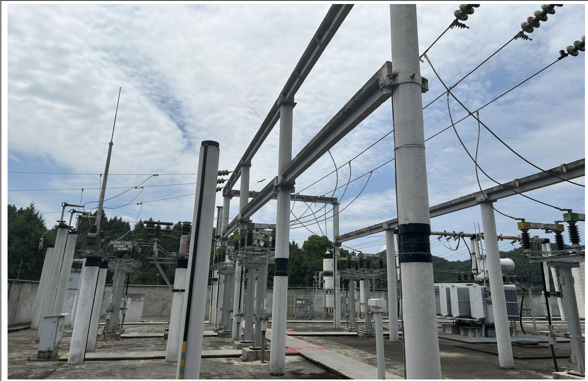
槐树 35kV 变电站 35kV 间隔扩建工程站区现状
