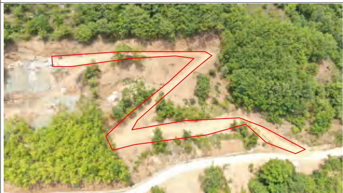
杆塔号：N5190 施工道路无人机正射影像解译（2024.6），道路长度 124.7m，宽度 4.0m。
