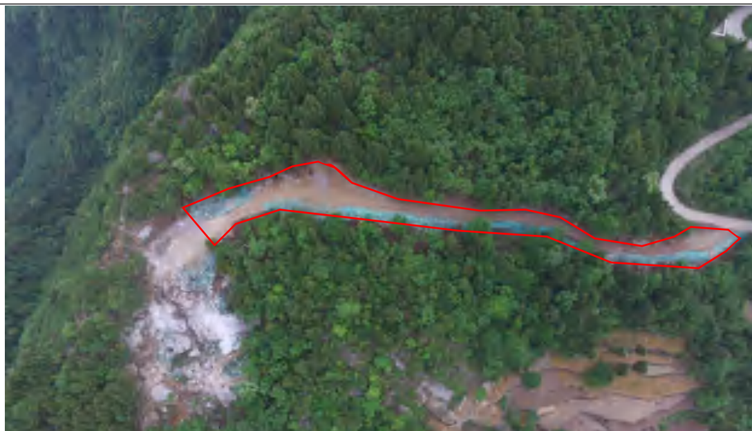
杆塔号: N5508 施工道路无人机正射影像解译 (2024.6), 道路长度 144m, 宽度 4.0m。
