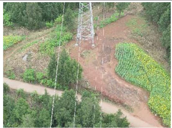
P18 塔基及道路需尽快恢复
