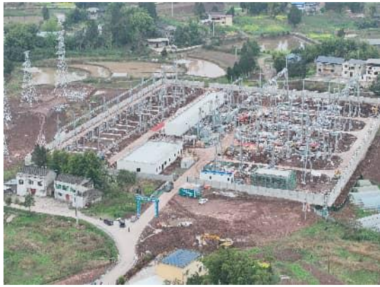
新建朗池 220kV 变电站
