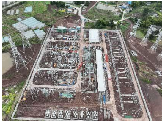
新建朗池 220kV 变电站
