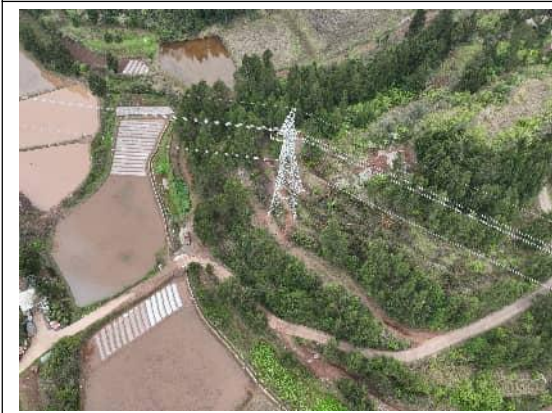
P19 塔基及道路需尽快恢复
