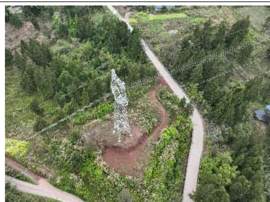
P30 施工道路需尽快恢复
