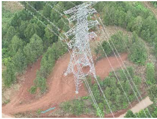
N97 塔基及施工道路尽快恢复
