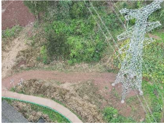
P47 需对塔基及道路进行恢复
