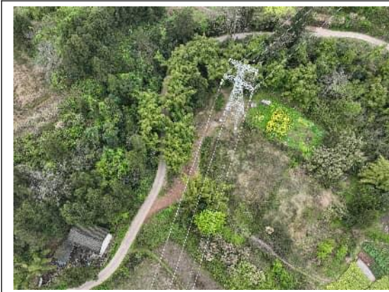
P31 塔基及施工道路需尽快恢复
