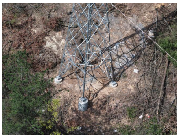
永安一岭上 N13 砂石料未清理，未及时进行覆土、土地整治和植被恢复
