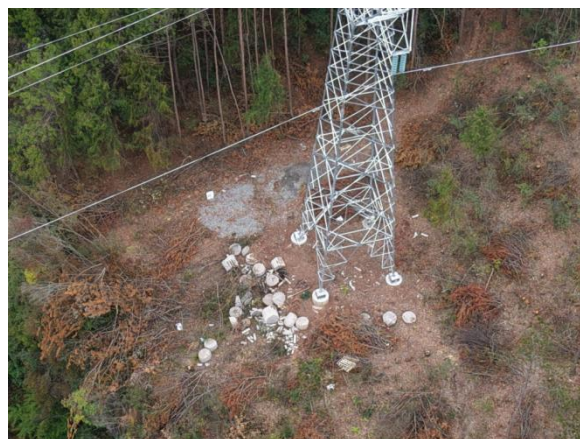
草池一岭上 N36 砂石料未清理，余土（石）堆放散乱，未进行覆土、土地整治和植被恢复
