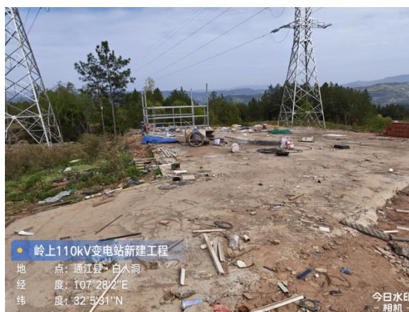
材料堆放及加工场地硬化地面未拆除，垃圾、建渣未清理
