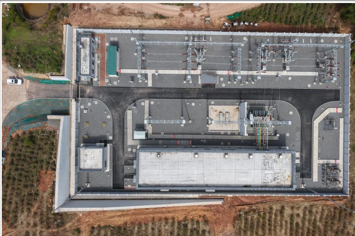
岭上 110kV 变电站
