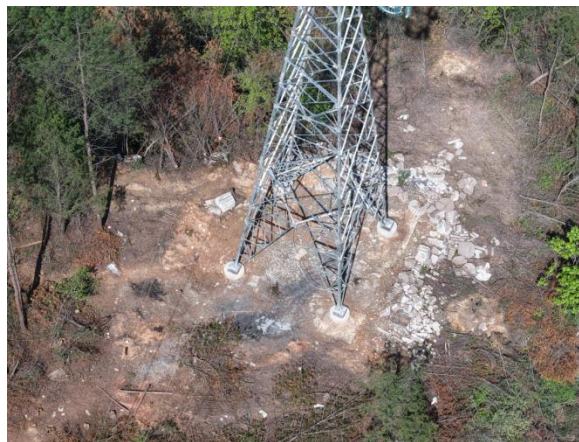
永安一岭上 N35 塔砂石料未清理，余土（石）堆放散乱，未及时进行覆土、土地整治和植被恢复
