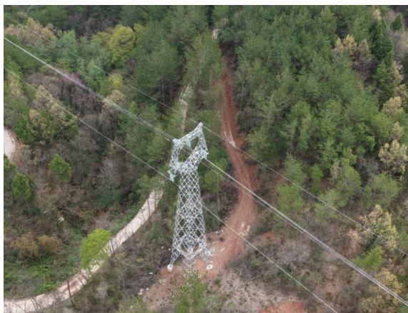
草池一岭上 N61 塔基及其施工临时占地，汽运道路未及时进行覆土、土地整治和植被恢复
