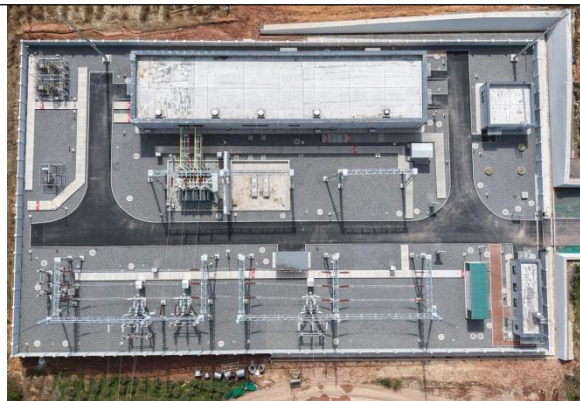
未及时实施站内植物措施
