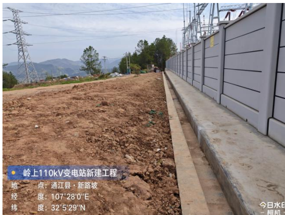
站外裸露地面未及时进行土地整治及植被恢复
