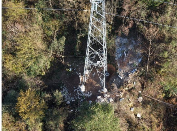
草池一岭上 N17 砂石料未清理，余土（石）堆放散乱，未进行覆土、土地整治和植被恢复
