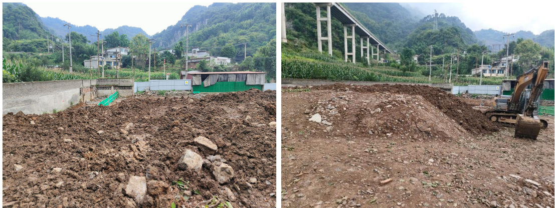
图5-1 变电站堆土苫盖不到位
