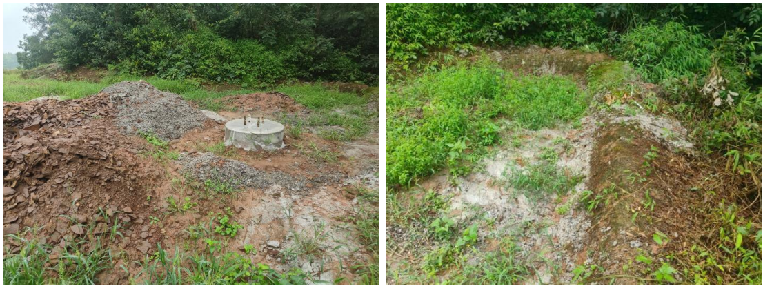
图5-1、图5-2 塔基区清理不到位
