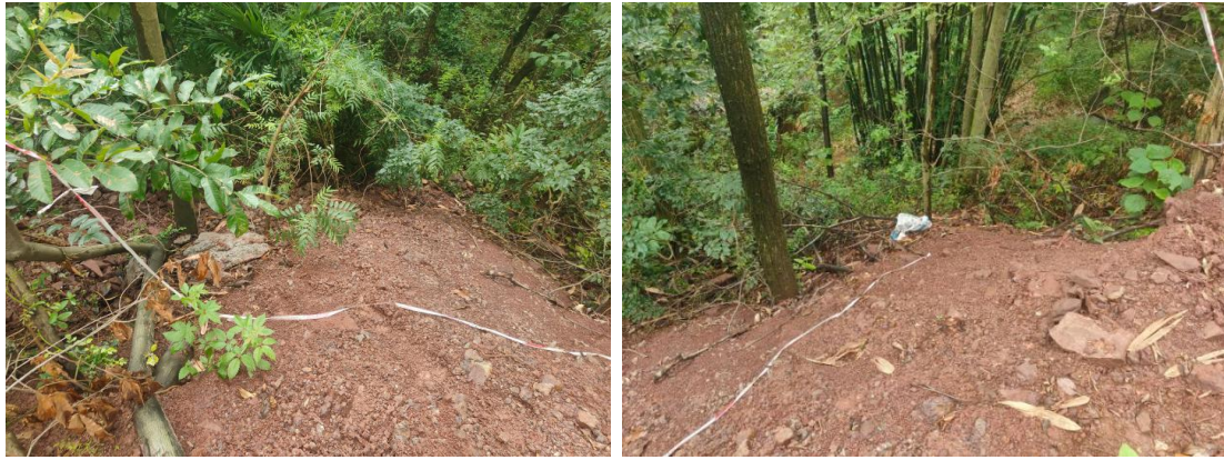
图5-3、图5-4 塔基区存在溜坡
