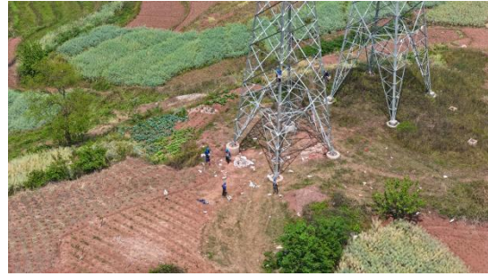
AN01 已组建塔基临时土堆裸露,建议及时苫盖,施工结束立即覆土、复绿(2026.3)
