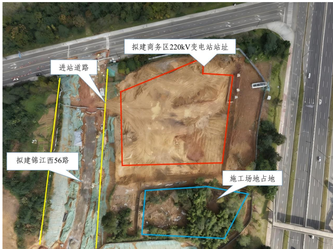
图3-1 变电站区无人机航拍
