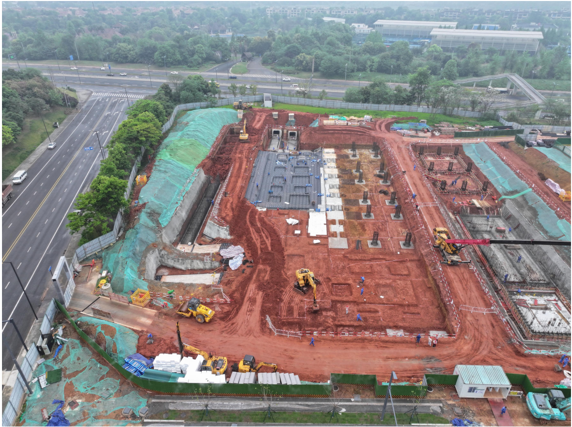
图3-1 变电站区无人机航拍
