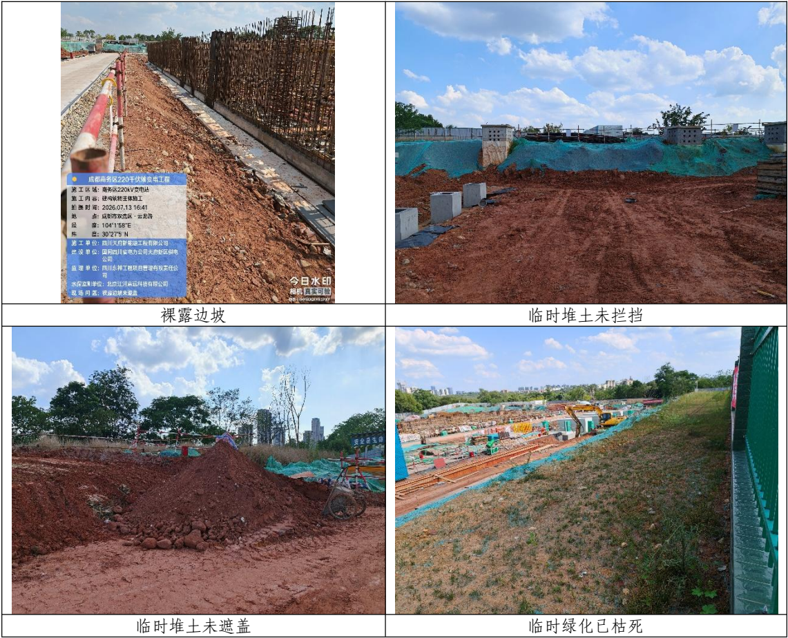
图 5-1 施工现场问题
