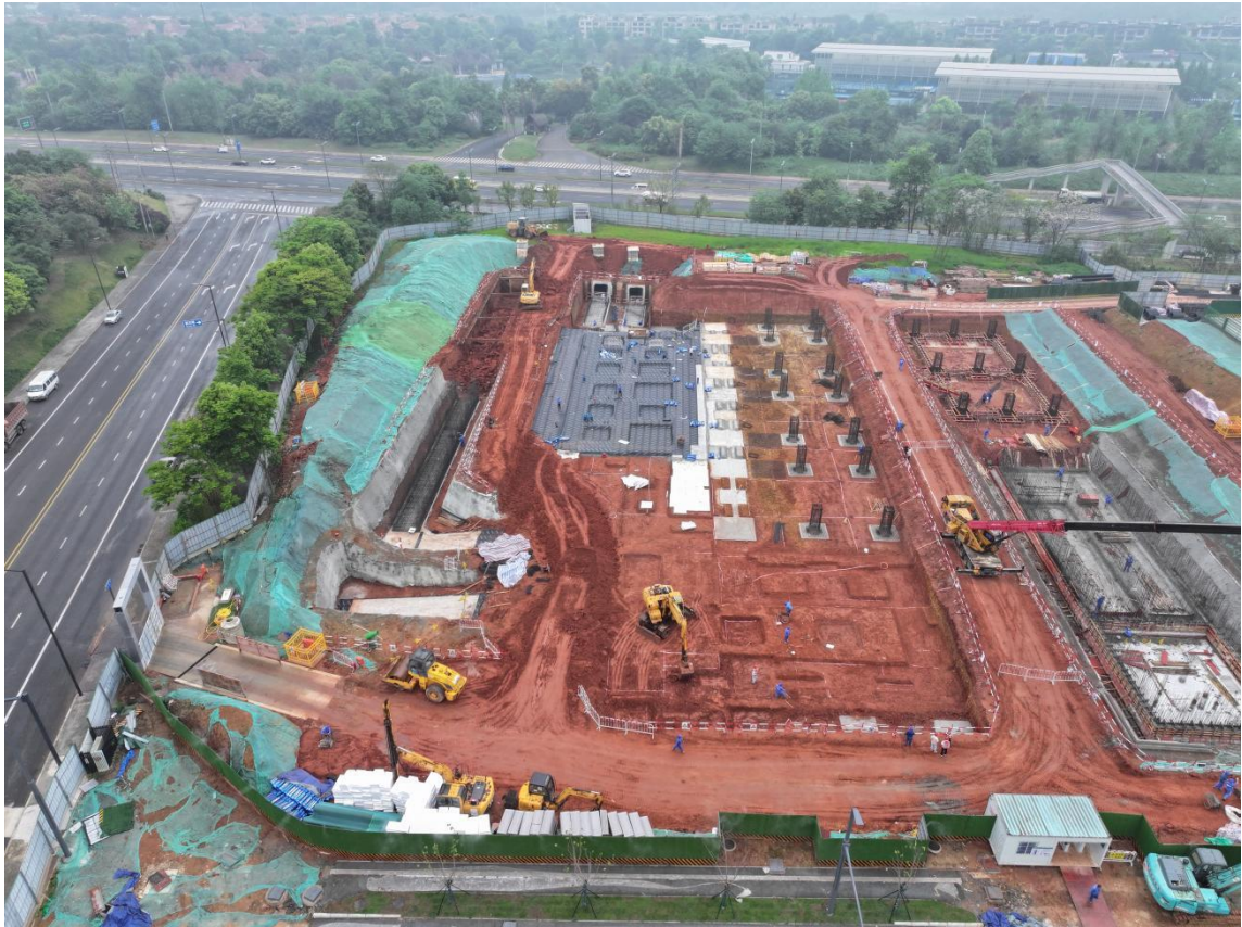
图 3-1 变电站区无人机航拍
