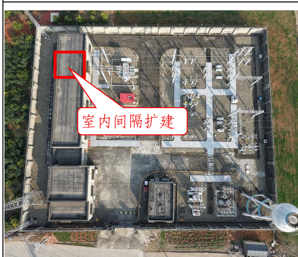
福兴 35kV 变电站
