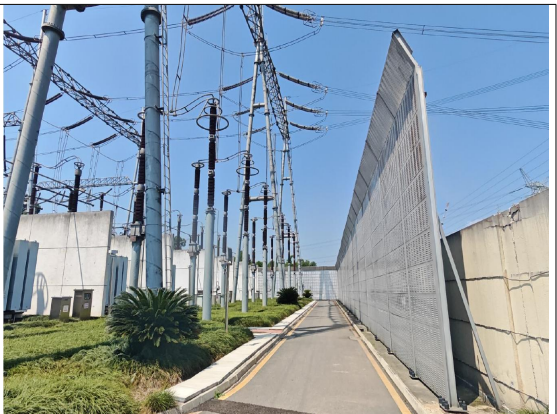
图 3-8 西北侧、西南侧声屏障（总长约 95m，均位于站内）
