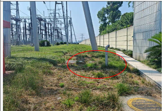
图 3-9 500kV 东天一、二线高抗事故油池（约 20m 3 ）
