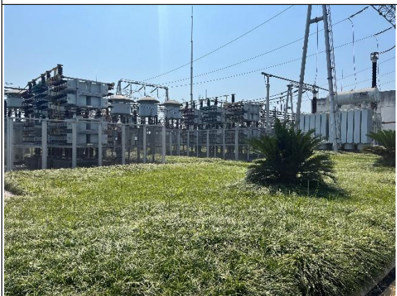
站内 35kV 配电装置扩建区域
