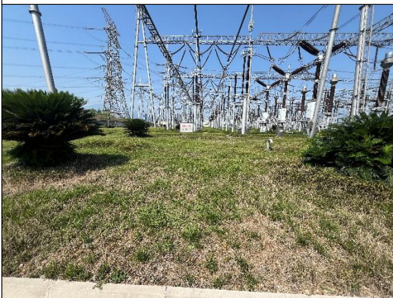
站内 500kV 配电装置扩建区域
