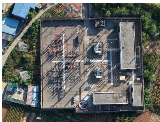
凯江 110kV 变电站
