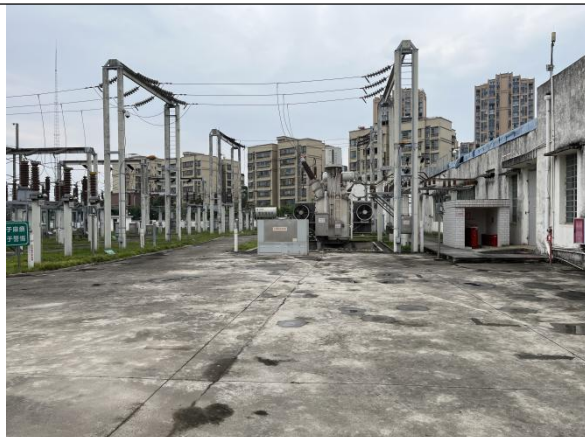
花菱 110kV 变电站现状
