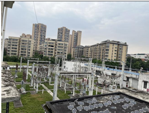
花菱 110kV 变电站现状
