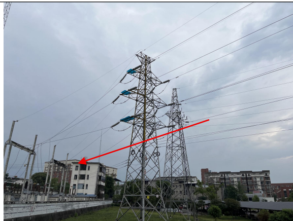
安县-花菱 110kV 线路止于花菱 110kV 变电站
