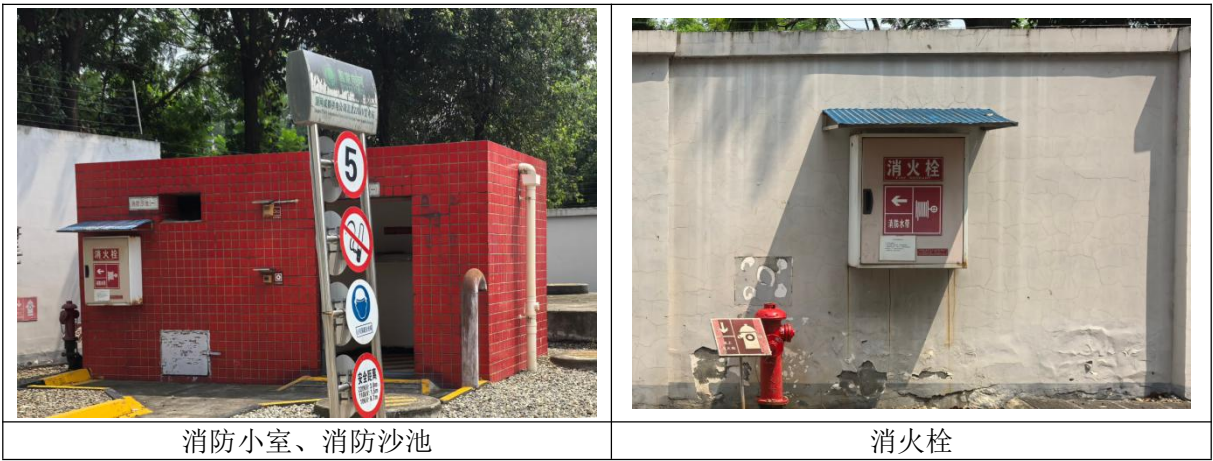
图8-3 清波220kV变电站站内消防小室、消防沙池及消火栓
