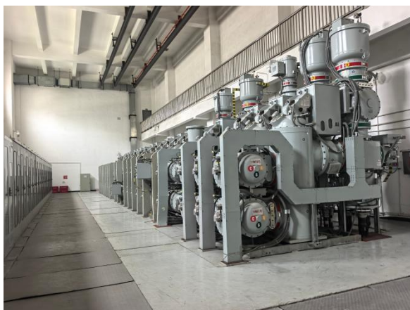
110kV 配电装置
