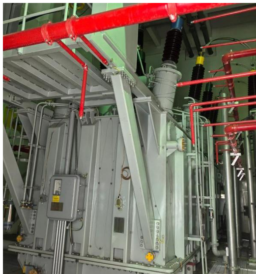
3 号主变（本期扩建）
