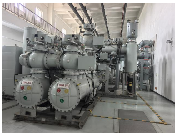
220kV 配电装置
