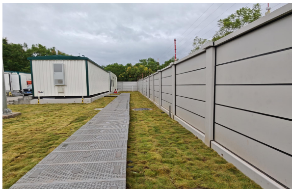
变电站绿化现状
