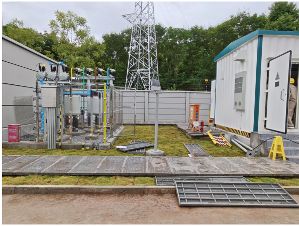
变电站绿化现状
