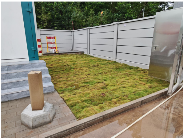
变电站绿化现状
