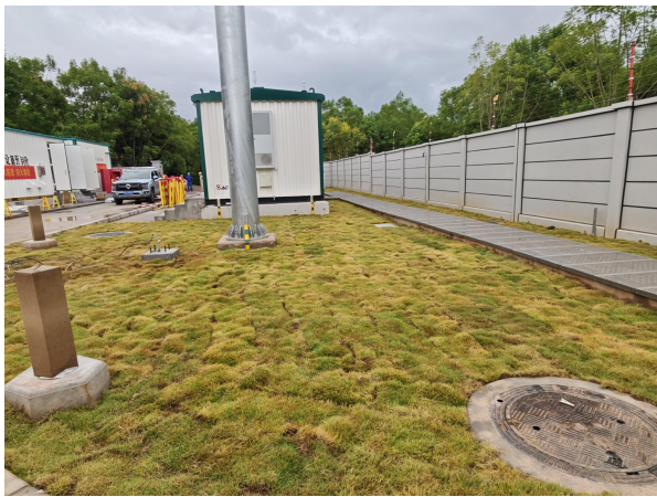
变电站绿化现状
