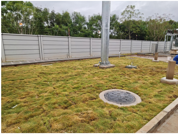
变电站绿化现状
