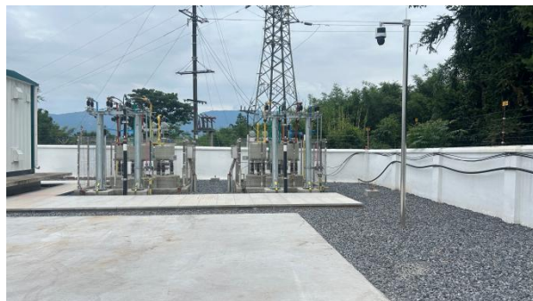
站内东北角电容器场地碎石地坪
