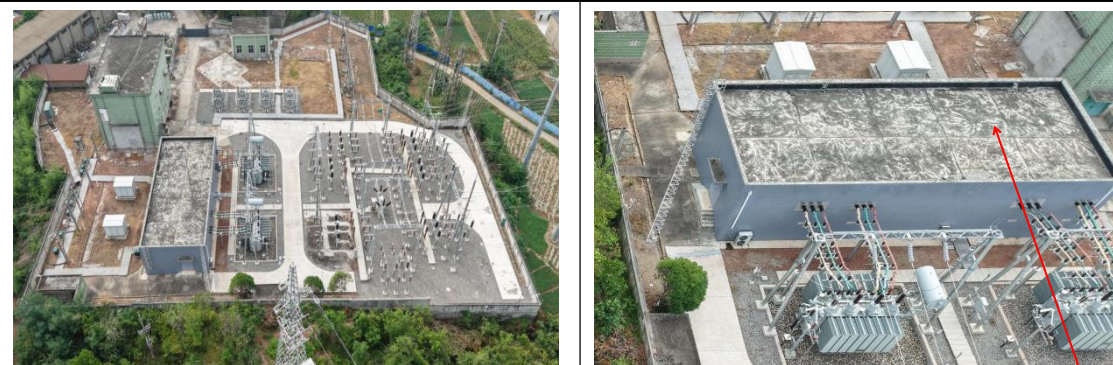
中江 110kV 变电站现状
