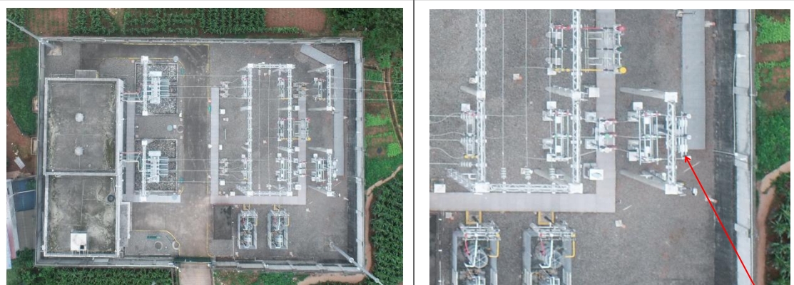
集凤 35kV 变电站现状
